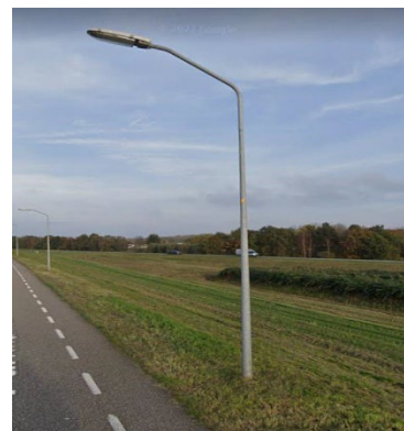
Figuur 6-33: Voorbeeld van het type straatverlichting langs de IJsselmeerdijk bij de toegang naar de wijk Parkhaven.
